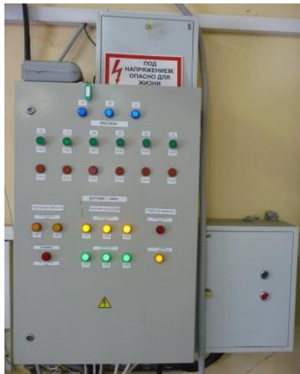
Рис.4.1.3.Шкаф управления насосами и автоматикой
